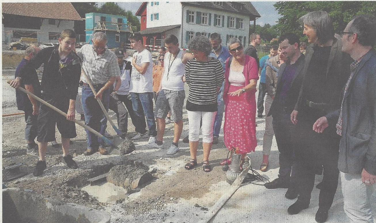
Symbolischer Moment: Eine «goldene» Truhe wird ins Fundament des neuen Werkstattgebäudes eingelassen.
